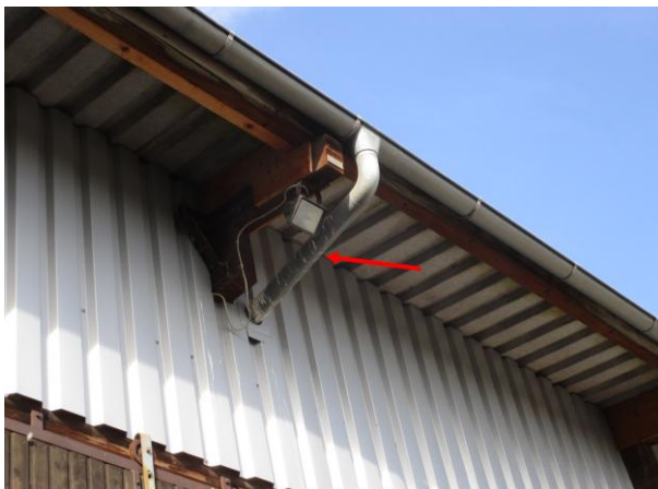
Abb. 15: Vogelkotspuren an Dachrinne (Stand 2021)
