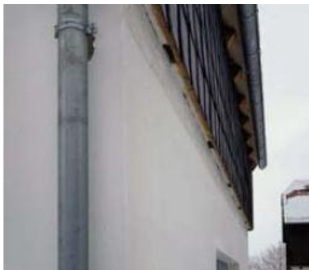
Abb. 19: Spaltenquartiere hinter Schieferverkleidung 6
